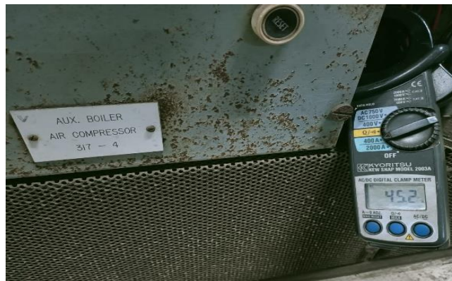
Gambar 3. Pengambilan Arus Kerja Motor Pada Kabel MCC 380V Menggunakan Tang Ampere
