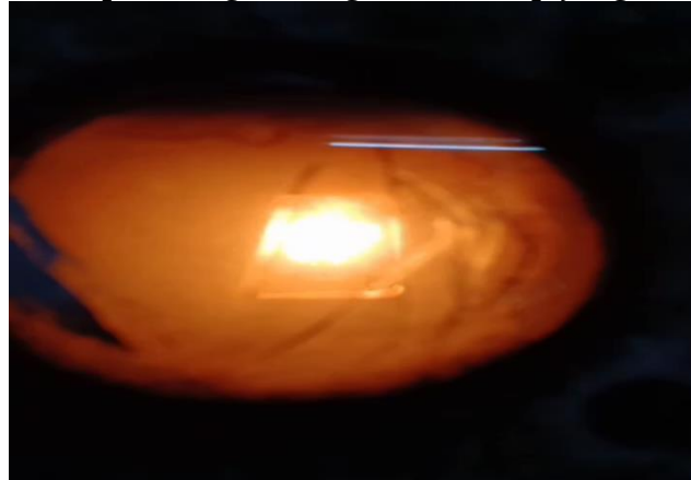
Gambar 5. Indikasi Penyalan Pembakaran Boiler Dilihat Dari Glass Gauge
